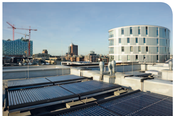
> Solarthermie-Anlage im Hamburger Hafen
